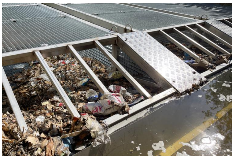
Dispositif de collecte des macro-déchets aux exutoires (©Vertuoso)
