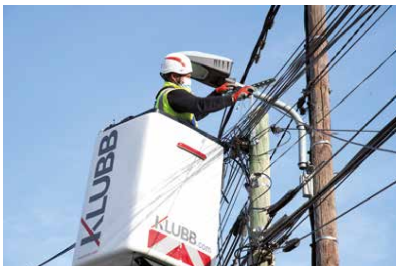
Le réseau aérien en campagne, reste l'une des difficultés techniques pour le déploiement de la fibre.
