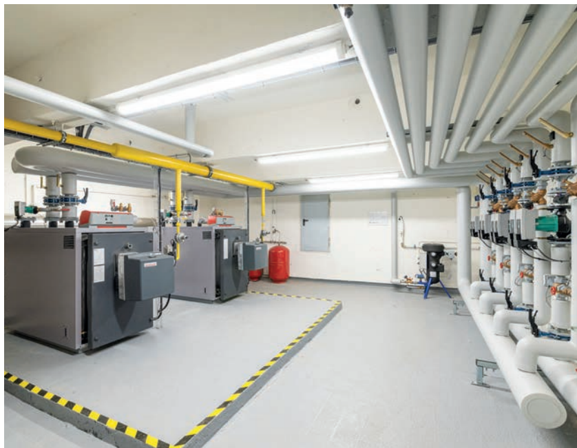
La nouvelle chaufferie de l'école du Pont de l'Arc
