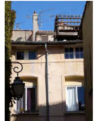
Terrasse disgracieuse posée sur la couverture.
