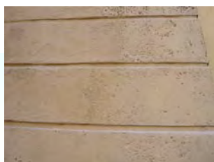
Motifs de joints creux dans l'enduit
