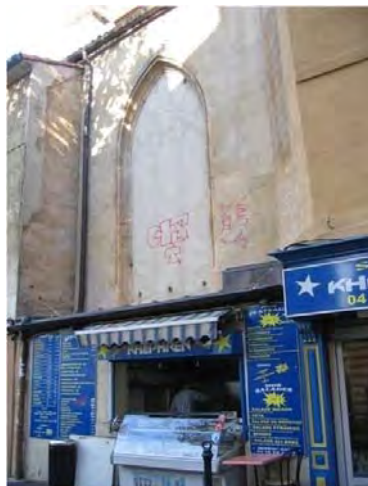
Rue Portalis l'installation d'un snack contre le mur gouttereau de l'église Sainte-Madeleine ne respecte pas la composition de l'édifice.
