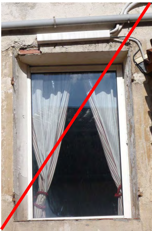
Menuiserie inadaptée à l'ouverture
