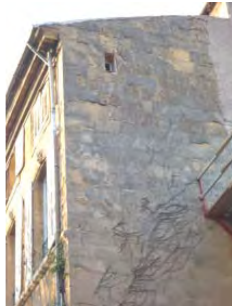
Pierre desquamée derrière enduit dégradé
