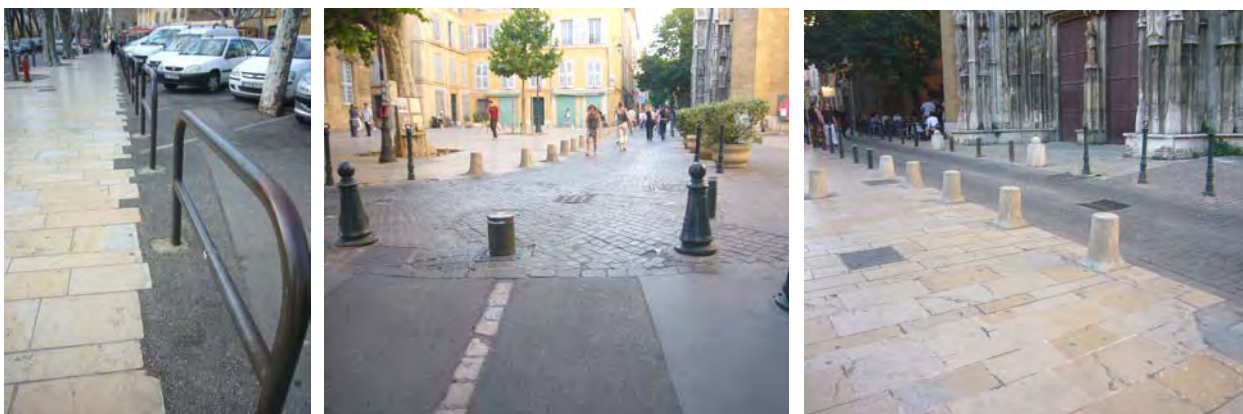
La multitude de matériaux, de calepinage, de mobilier urbain de types différents nuit à la lecture de l'espace public. Le parvis de la cathédrale est interrompue par la bande roulante.
