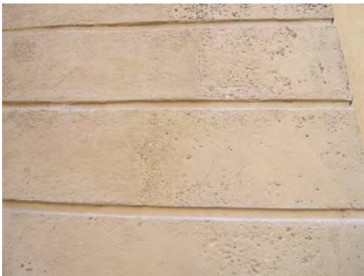
Motifs de joints creux dans l'enduit
