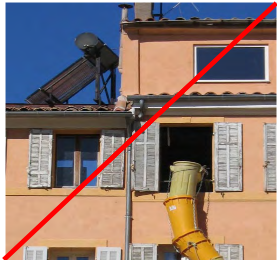
Exemple de panneaux solaires disgracieux posés à contresens du plan de la toiture et particulièrement visibles
