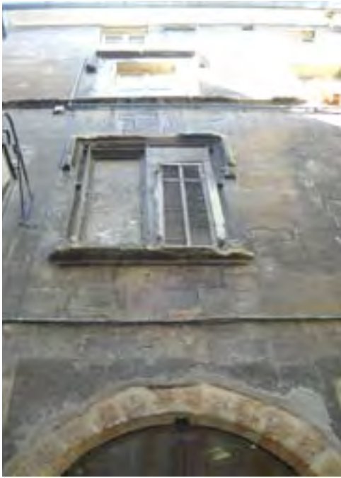
Ancienne croisée dont la traverse est manquante, baie en partie bouchée
