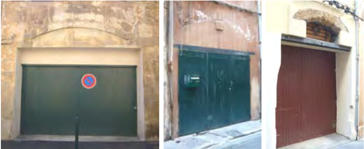
Anciennes baies de remise remaniées : restituer la baie d'origine, porte contemporaine à déposer et à remplacer
